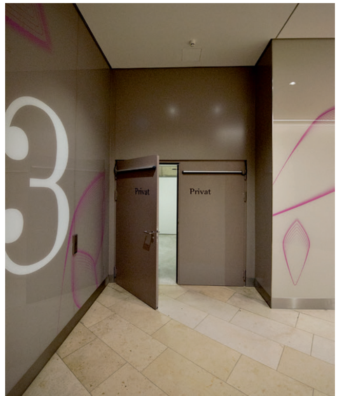
Doppelflügelige Brand- und Rauchschutztür im Minto.
