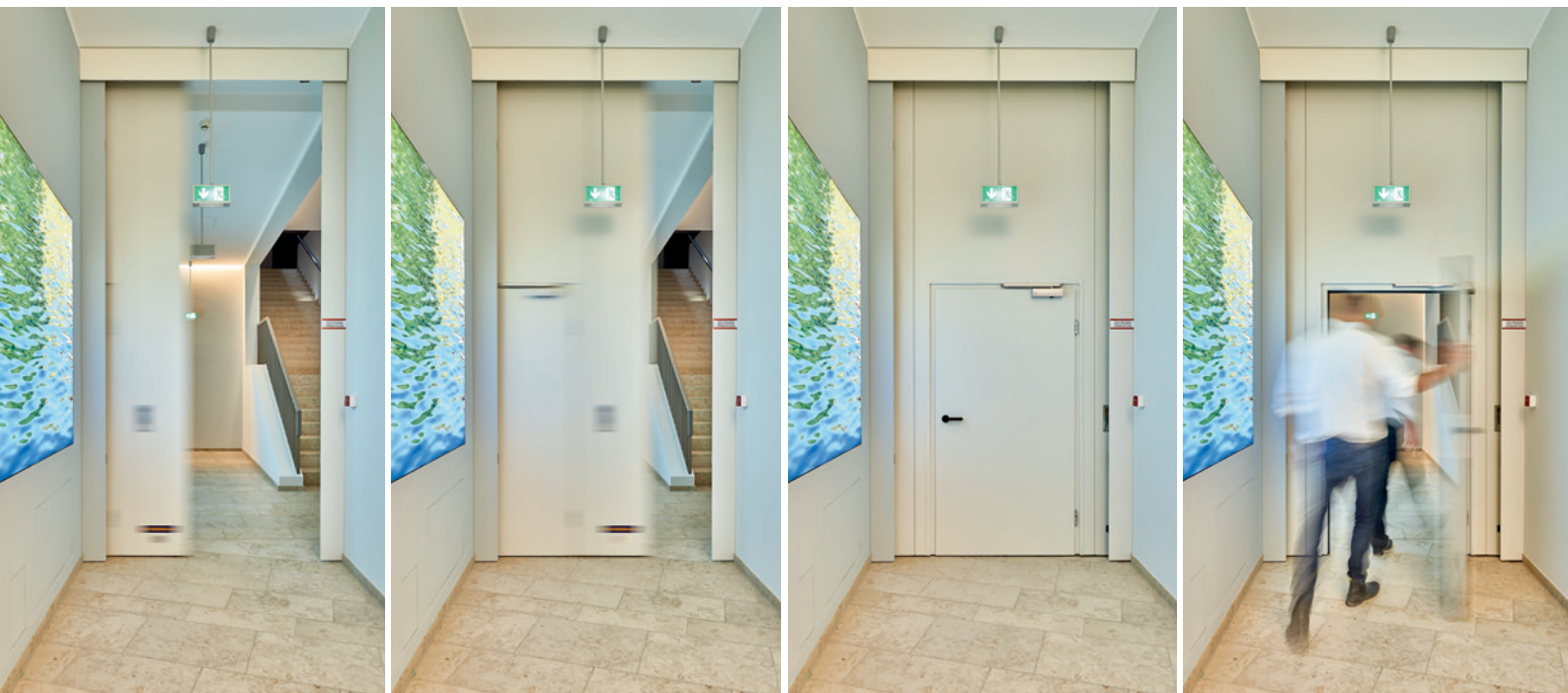
Im Brandfall schließt das Feuerschutz-Schiebetor automatisch. Eine Schlupftür gewährleistet, dass die Bewohner bei geschlossenem Tor fliehen können.
